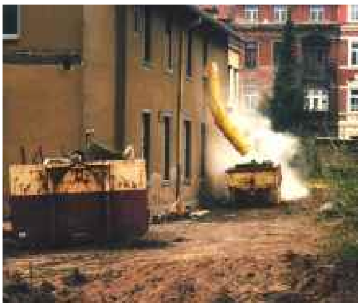
Tonnenweise Schrott und Bauschutt
