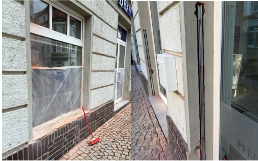
Der Flutschutz an unserer Geschäftsstelle auf dem Niedermarkt in Döbeln: In die installierten Schienen werden Spuntwände eingesetzt.
